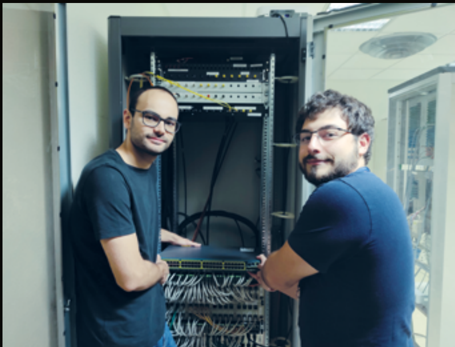
Nicolas DA COSTA et Anthony BREA lors d'une maintenance préventive de nuit courante, la remise à neuf de baies réseau.
